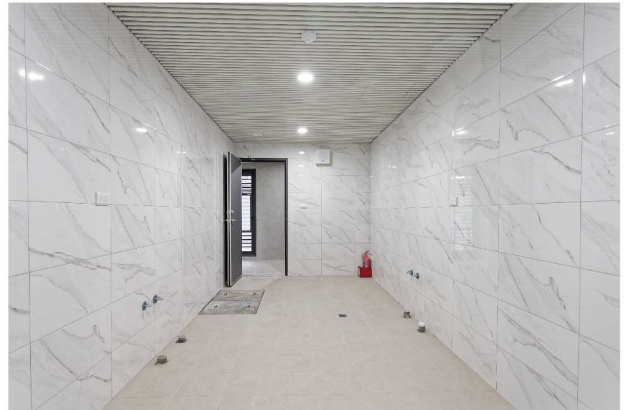
▲ 使用系列：地面 / 尼羅崗石 / 溪岩灰 / 霧面 牆面 / 絕色 / 浪漫 / 拋光
